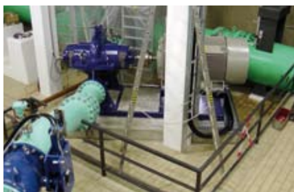
Blick in ein badenova-Wasserwerk.
