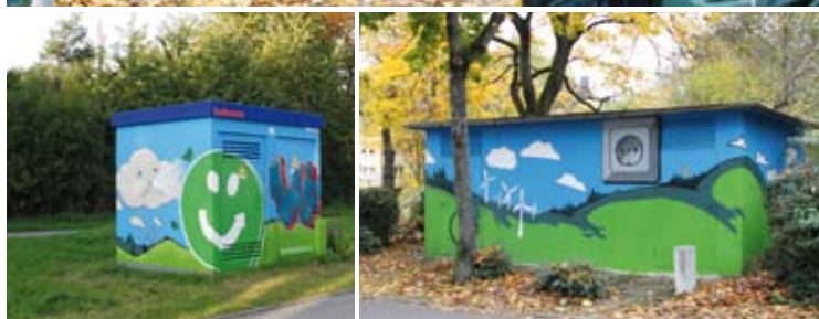
Graffiti-Aktionen an Freiburger Trafostationen.
